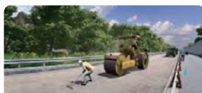
⑤ 重機巻き込み災害
